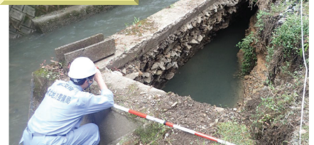
【R2.7月豪雨】 (熊本県錦町)
